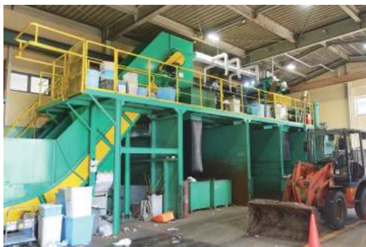
リサイクルプラント全体
